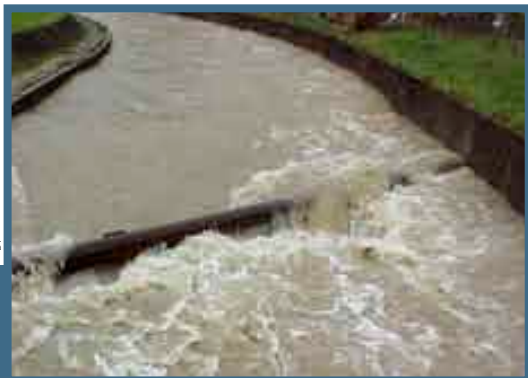
Collecteur des eaux usées traversant la Versoix, 2002.
