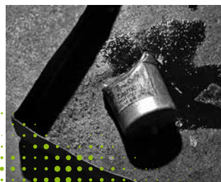
ENDOMMAGEMENT DES CONDENSATEURS
