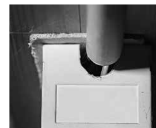
CARTON AMIANTÉ DERRIÈRE UN LUMINAIRE
