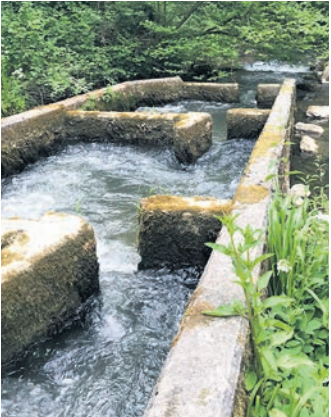
L'échelle à poissons.
